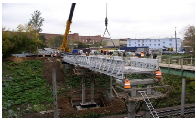
Рисунок 2. Монтаж центрального пролета пешеходного моста через железнодорожные пути в районе платформы «Чертаново» Московской Павелецкой дороги
